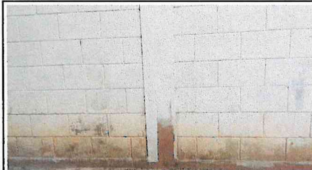
Foto 4: PINTURA EN TOTAL DETERIORO
