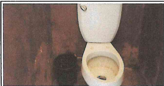
Foto 5: SUSTITUCIÓN DE INODORO, EN COMPLETO MAL ESTADO Y TAPADOS
